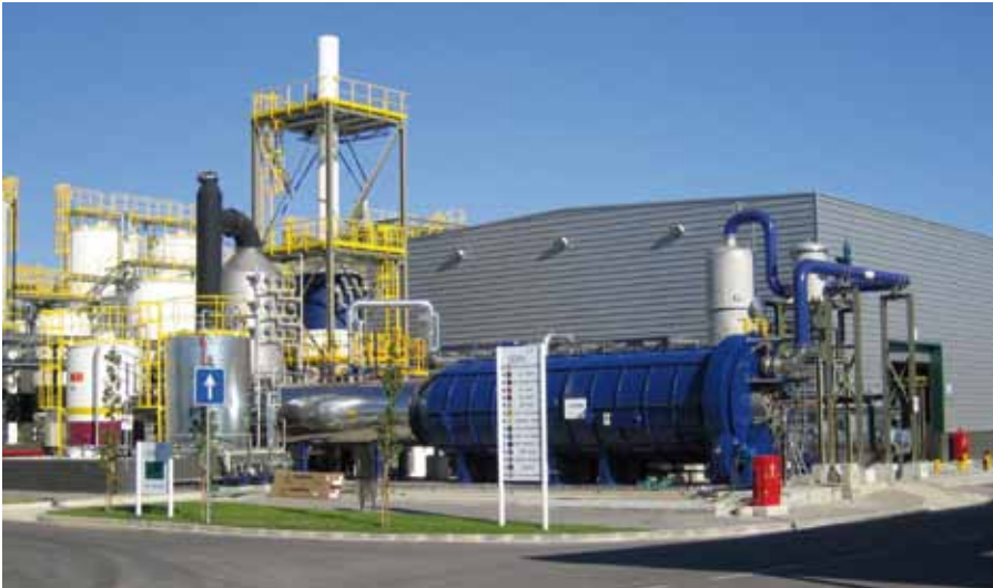
Vista exterior de una planta de tratamiento de aguas residuales mediante evapo-oxidación
