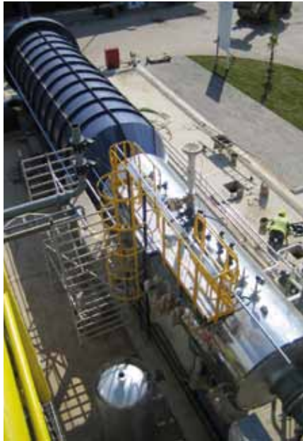
Vista parcial de la planta
